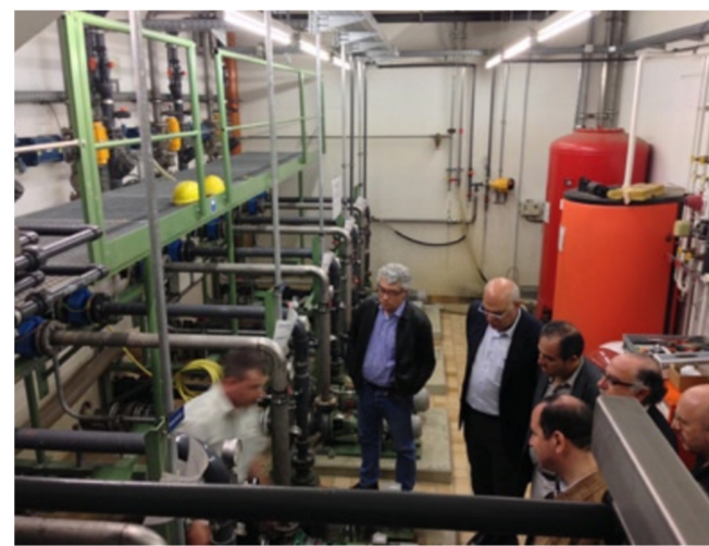
Dans cette pièce parviennent, à travers des tuyaux, des échantillons des rives des trois pays, pour des analyses fréquentes.
